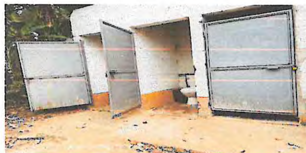
MANTENIMIENTO A PUERTAS DE SANITARIOS CAMBIO DE TUBO, LAMINA Y PINTURA EN LA PARTE INFERIOR
